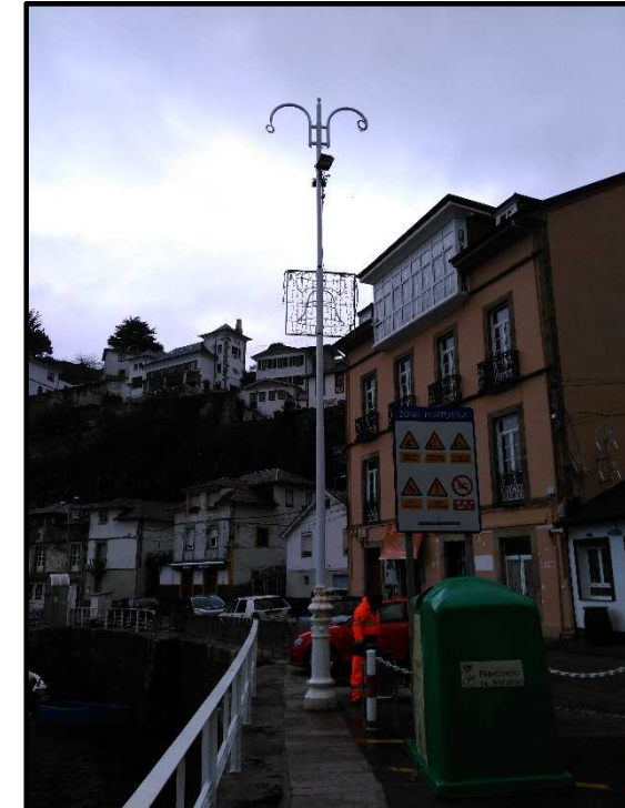
Vista General del estado de oxidación que presenta alguna de las columnas.
