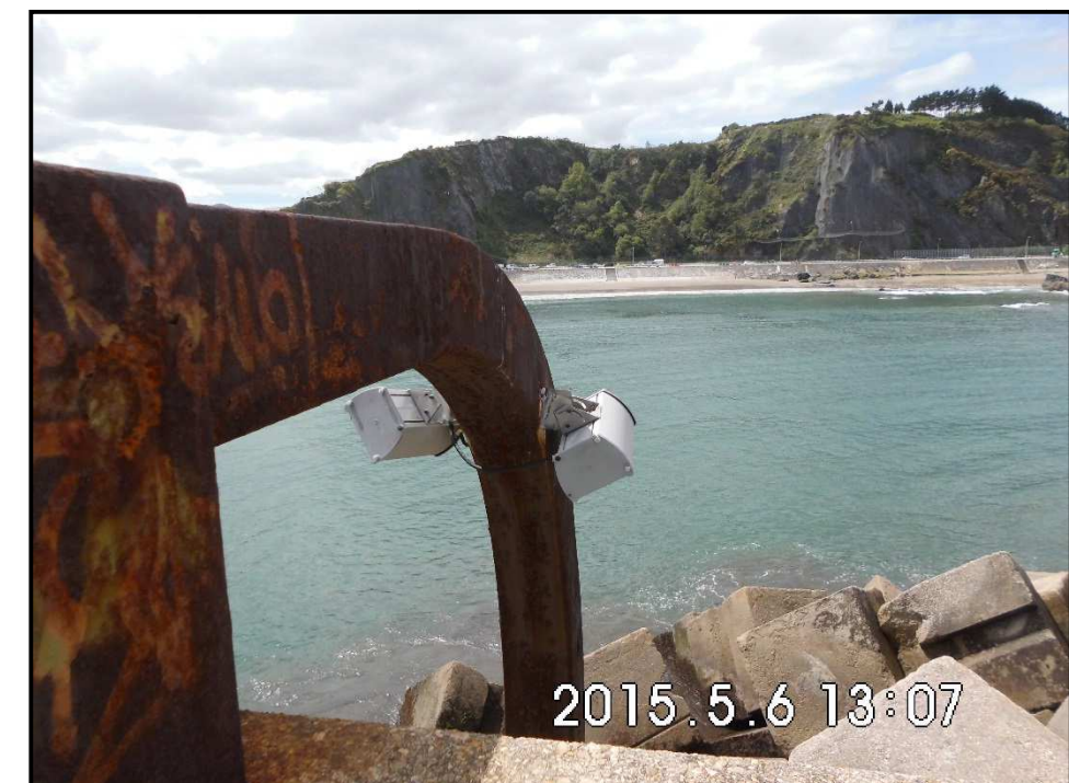
Vista General de Proyectores Existentes para iluminación de dique.
