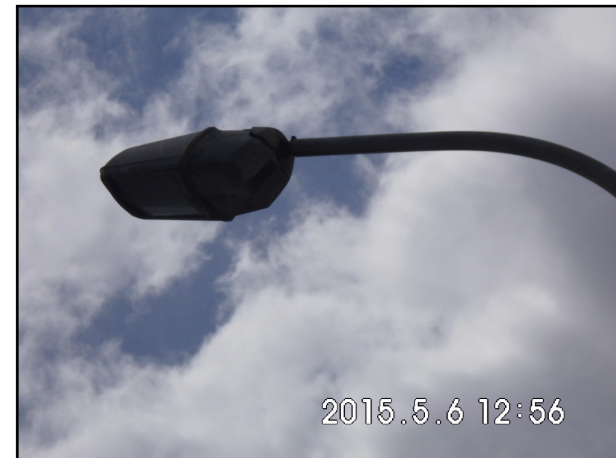
Vista General de los daños que presentan algunas de las luminarias.
