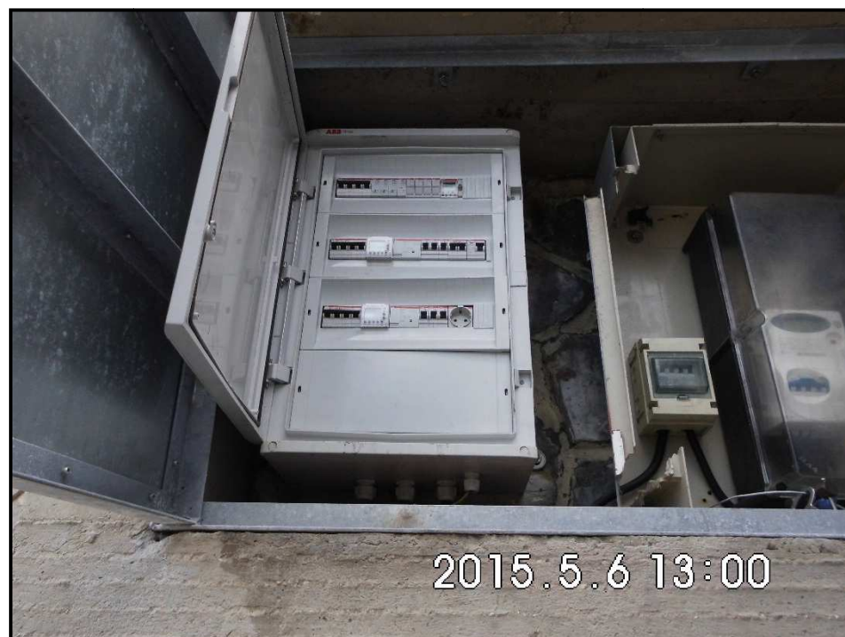
Vista General del interior del armario de mando.
