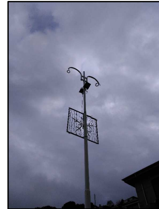
Vista General de Punto de Luz existente en el Paseo (Tipo Clásico 1).
