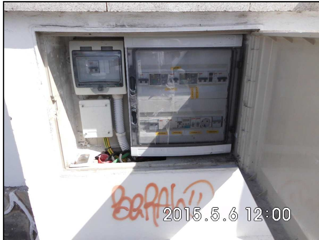
Vista General del Armario de Mando y Protección de la Instalación
