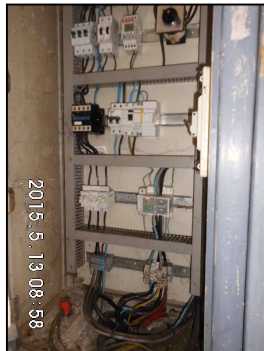
Vista General del CM de la Instalación.
