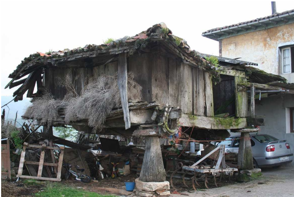
Hórreo del siglo XVII en completo estado de abandono por falta de uso.
