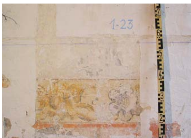
Diferentes tramos de los revestimientos de pintura mural de las paredes interiores.
