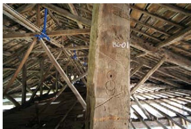
Marcas de círculos, semicírculos y aspas documentados en las vigas de los forjados y del bajocubierta.
