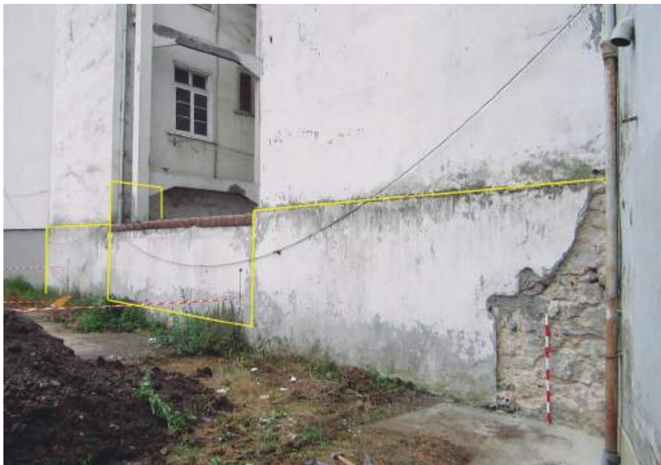
FIGURA 21: Vista de los vestigios de la muralla conservados en la trasera del n.º 23. En primer término se aprecia la zona en la cual el revestimiento de la pared se encuentra desprendido, lo que permitió documentar el probable paramento interno de la muralla en esta zona.
